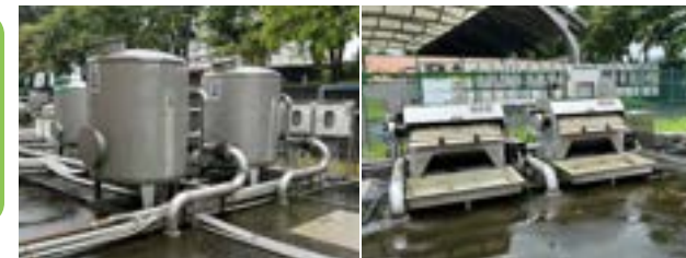
▲ 第一校區污水處理廠
